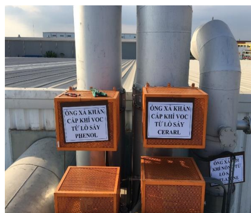
03 ống xả sự cố của hệ thống RTO
