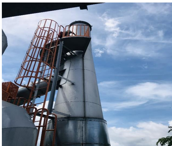
Ống thoát khí của hệ thống RTO
